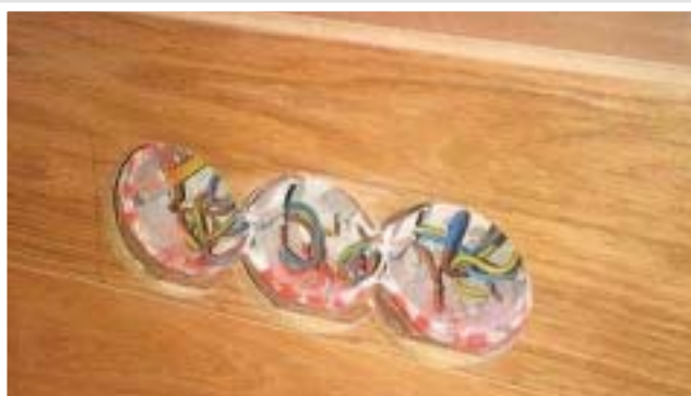
Detail instalační krabíčky. Jako finální povrch byla zvolena dřevěná dýha celoplošně lepená k deskám Wolf.
